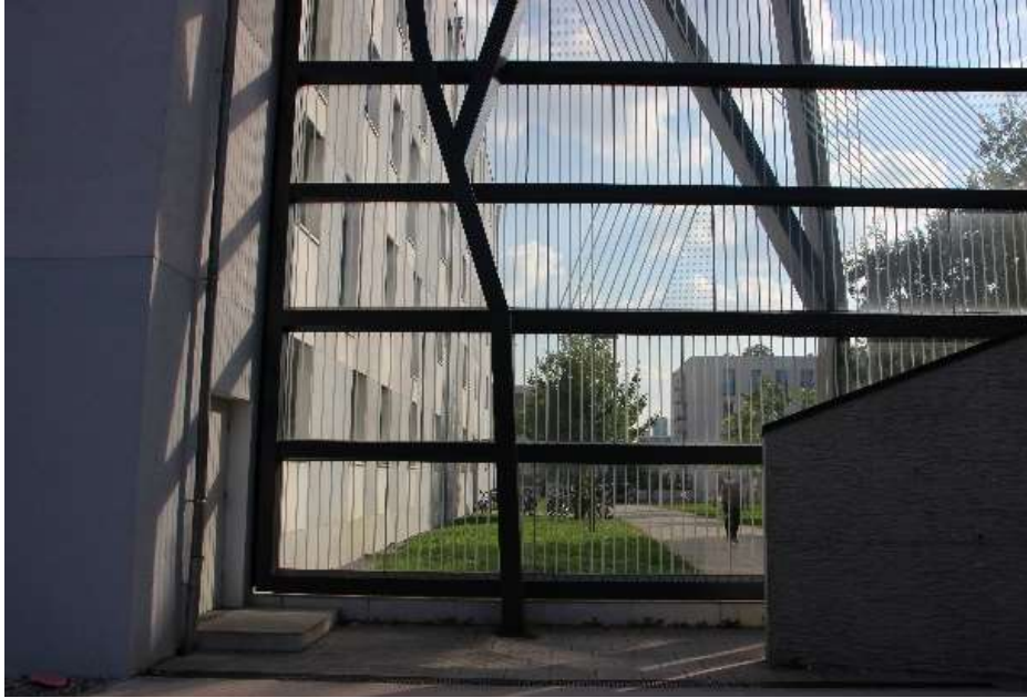
Abb. 63. Strukturierte Schallschutzwand Frankfurter Ring mit vogelschlagsicherer Markierung (Foto: E. Wölf)
