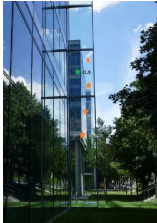
Abb.28. Windabweiser am Osram-Hochhaus (Foto: E. Wölf). Sterne entsprechen Kollisionsspuren (orange: Ersterfassung am 7.8.20, grün: 21.9.20)
